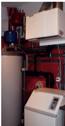
Dwupłaszczowy zbiornik c.w.u., pełniący również rolę bufora i pompa ciepła Nibe Fighter 1150. Powyżej znajduje się moduł wentylacyjny FLM 30
