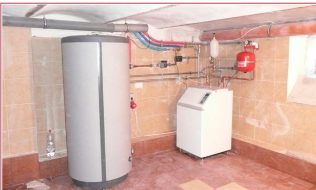
Fot. 2 Pompa ciepła Nibe Fighter 1150 + zbiornik CWU NIBE VPA 300/200 (naczynie przeponowe CWU „schowane” za zasobnikiem).
