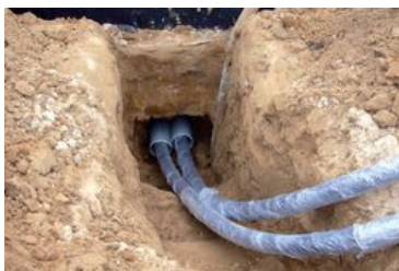
Ciepłociąg łączący kolektor z pompą ciepła (wejście do budynku)
