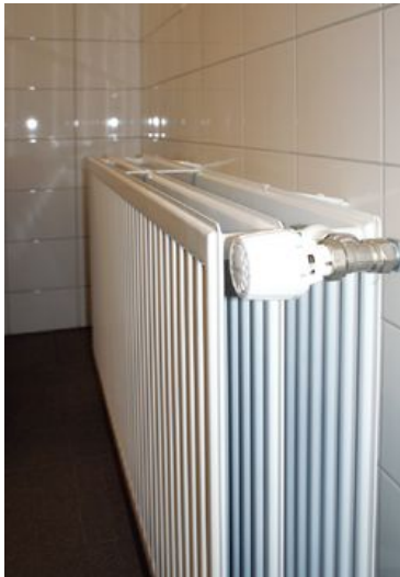
Grzejniki w laboratorium spełniają surowe wymogi sanepidu
