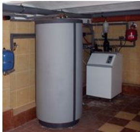
Pompa ciepła Nibe Fighter 1150 znajduje się w piwnicy razem ze zbiornikiem ciepłej wody użytkowej
