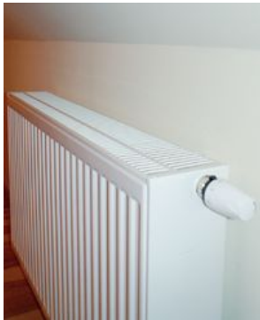
Grzejniki w pomieszczeniach na poddaszu zainstalowane są zarówno na ścianach kolankowych, jak i na szczytowych
