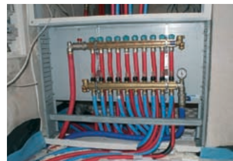
Fot. 4. Rozdzielacz ogrzewania podłogowego.
